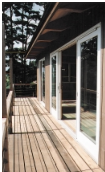
2階バルコニー。内部からの眺望を遮断しないよう、ステンレスワヤーを手すりに設置した
